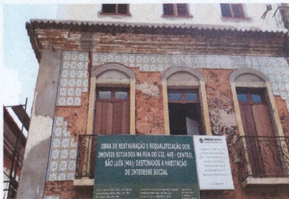
Figura 09 – Restauração e requalificação do imóvel situado à Rua do Giz, nº 445, Centro.
